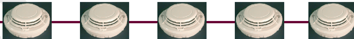
Linea 1 Rivelatori di Fumo locale A
